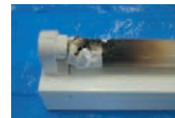
直管LEDランプの焼損例
